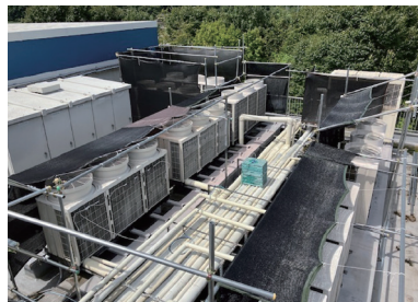
室外機への散水
