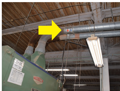
空気配管の漏れ防止
