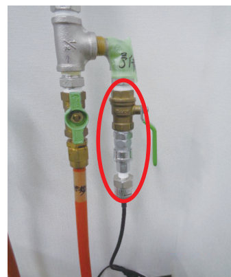
圧力センサー設置状況
