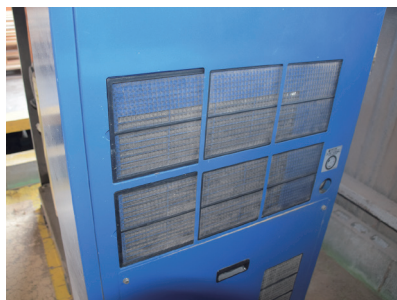
コンプレッサ吸込みフィルタの清掃
