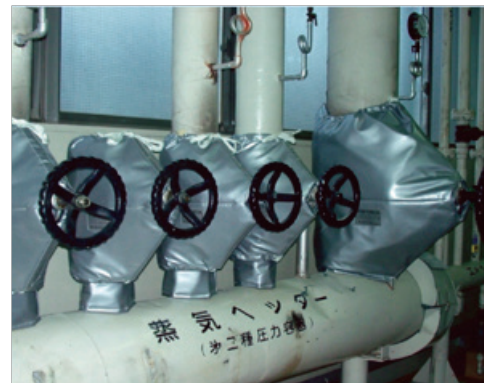
図 2 蒸気ヘッダ部バルブの保温状況例
