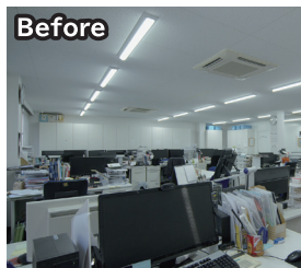
リニューアル前 (LED照明)
